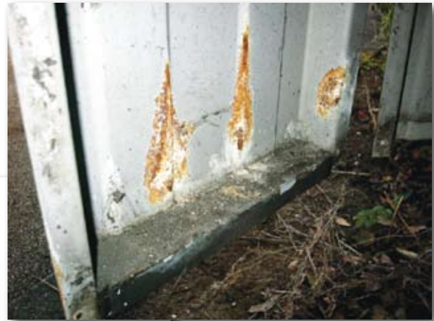
Ingesloten vocht in de spouw heeft een duidelijk negatieve invloed op de duurzaamheid van de hier toegepaste materialen.
